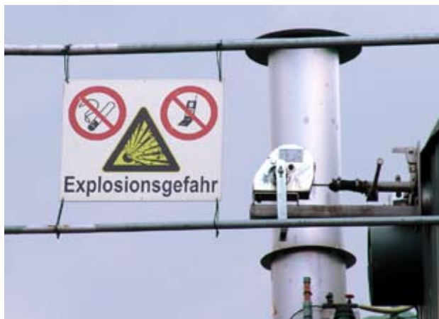
Die Betriebssicherheit vieler Biogasanlagen lässt zu wünschen übrig.
